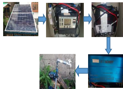
Gambar 1. PLTS Terhubung Ke Pompa Air
